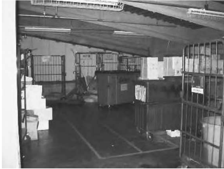
③屋内に設置した廃棄物処理施設 廃棄物処理施設も屋内化することにより、騒音の伝搬を防止している。
