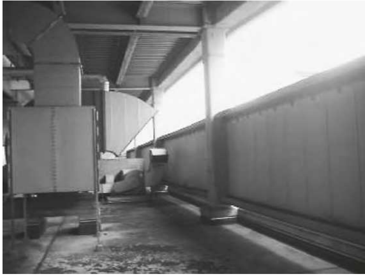
⑦空調室外機置き場 防音・目隠し壁
