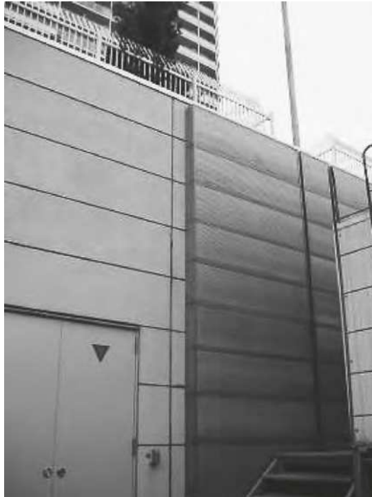
⑦冷却塔横に設置した吸音板
