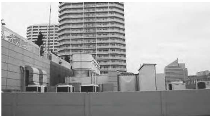
①屋上における設備機器類の集中配置 騒音レベルの大きい機器を集合住宅から離して設置している。
