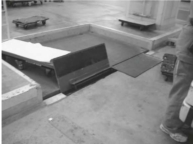
⑤荷さばき施設 リフター緩衝材
