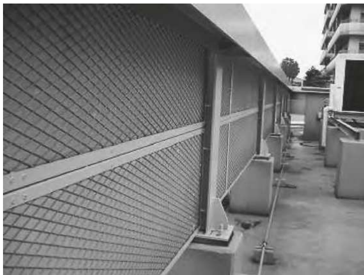
⑥屋上における空調室外機周辺の吸音板を貼り付けた防音壁
