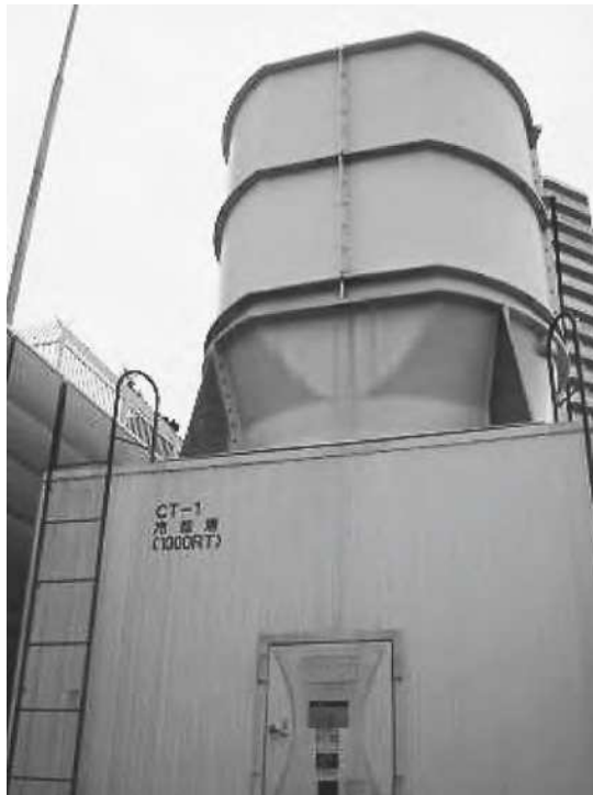
⑤低騒音型冷却塔
