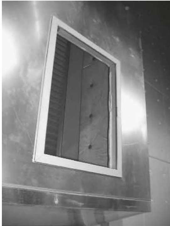
⑪機械室 ガラリ内側の吸音材貼り付け ダクトがガラリに面する場所に箱状の空間を設置し、吸音材を内張りしている。
