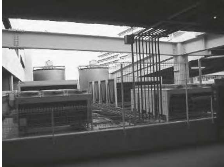
①冷却塔・空調室外機置き場
