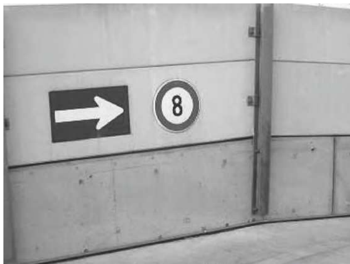
⑨車路の防音壁と速度制限表示
