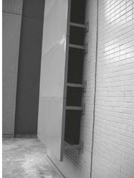
⑤ガラリー外部に設けた遮音板
