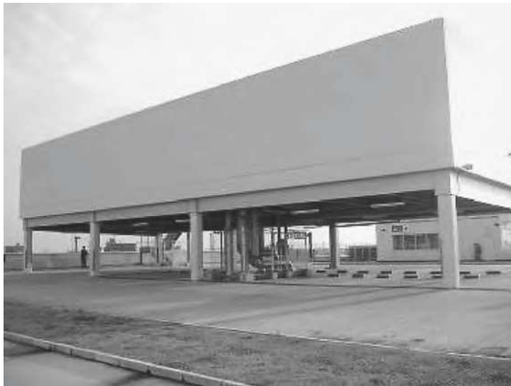
⑧屋上氷蓄熱冷却塔 防音・目隠し壁
