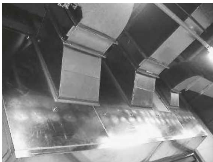
⑩機械室 ガラリ風切音低減ダクト接続
