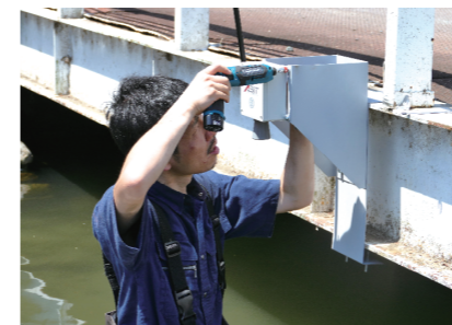
橋梁へのセンサー設置の様子
