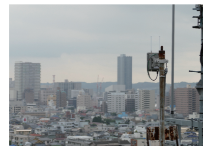
八王子市役所屋上の電波受信用アンテナ
