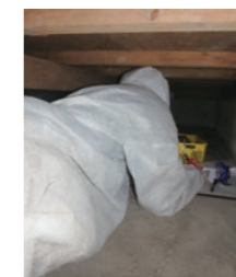
①住宅医とともに建物の実測調査を行い図面資料を作成
