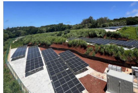
【評議平太陽光発電所】
