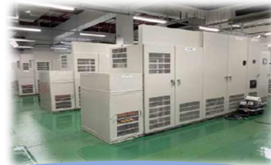
母島発電所 蓄電池
