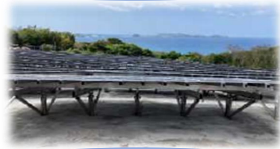
御幸之浜太陽光発電所
