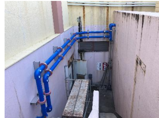
熱源水配管の機械室への接続部
