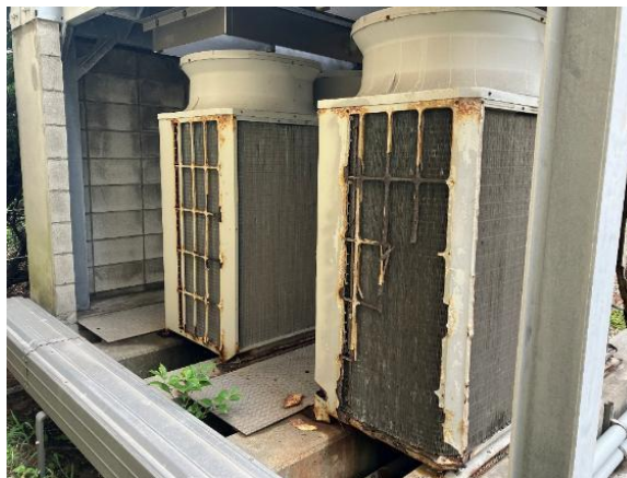
既設の空冷ビルマル室外機 塩害により劣化が進行している
