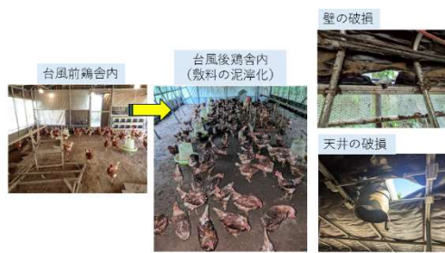
図1 A養鶏場の被害状況
