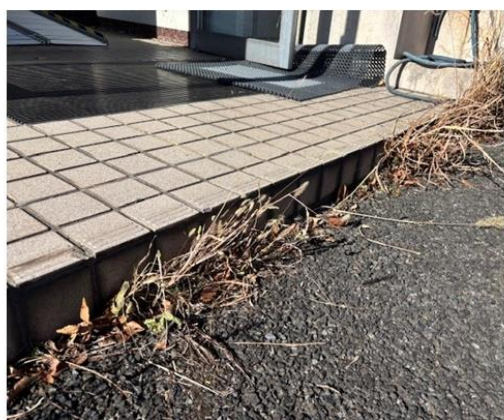
図4 立川庁舎室内の出入口の段差
