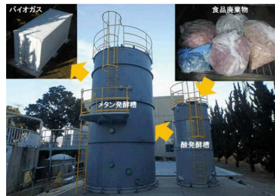
図表 10 バイオガス化実証試験施設 (出典 10)
