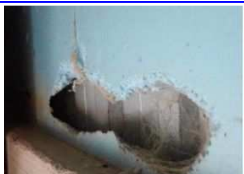
鶏舎壁面のラットサイン
