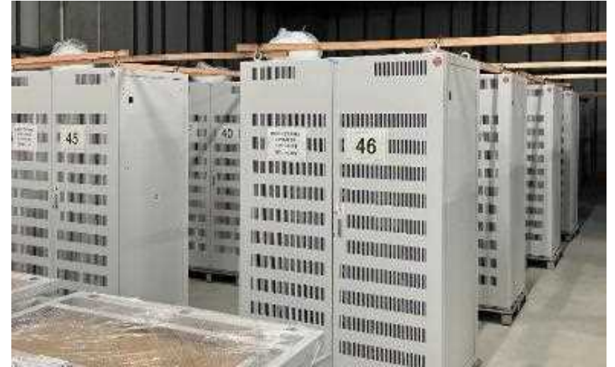
仮置き中の蓄電池
