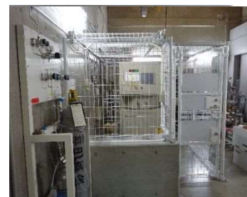
「第二非破壊検査室放射線防護設備」の整備
