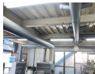
LED照明に交換した工場 交換してから2年以上経過したが、まだ一度も交換したことがない。
