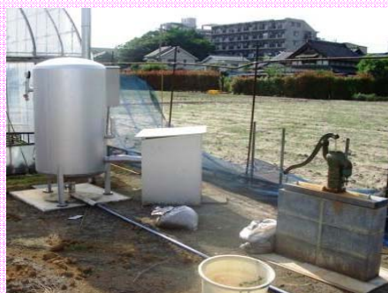
【事業で設置された防災井戸】
