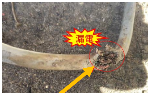
損傷していた キャブタイヤケーブル
