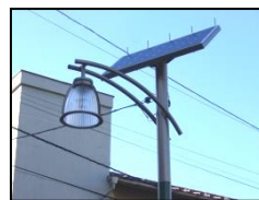
(太陽光発電システムを備えた街路灯)
