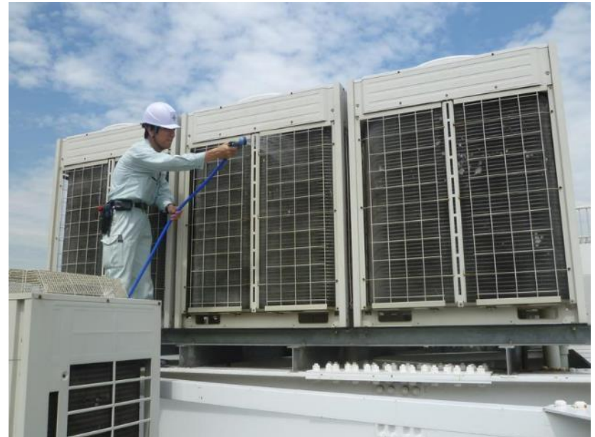
室外機への散水の例
