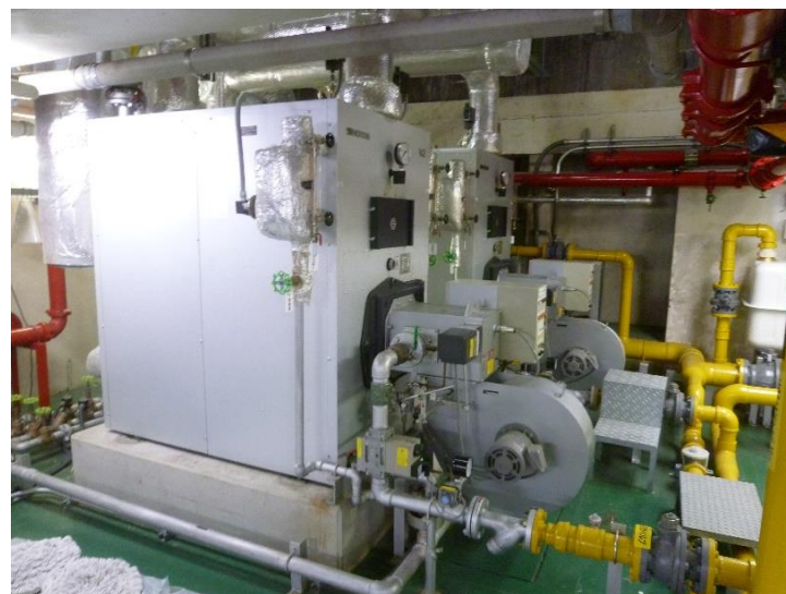
貫流ボイラ(1t×2台)
