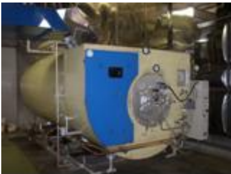
炉筒煙管ボイラ(10t×2台)
