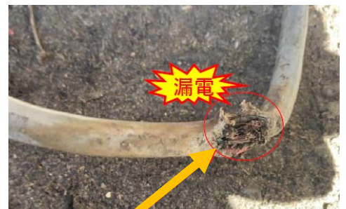
損傷していたキャブタイヤケーブル
