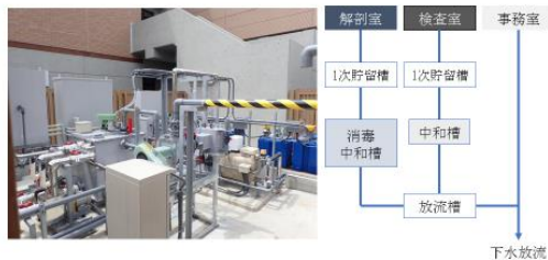
図9 排水処理によるバイオセキュリティ確保
