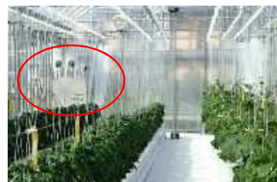
ヒートポンプ
